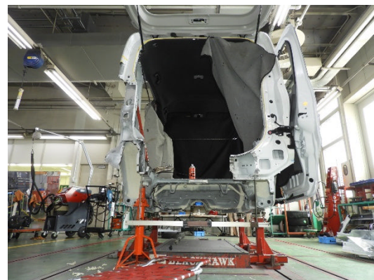
損傷部品を取外した状態。
