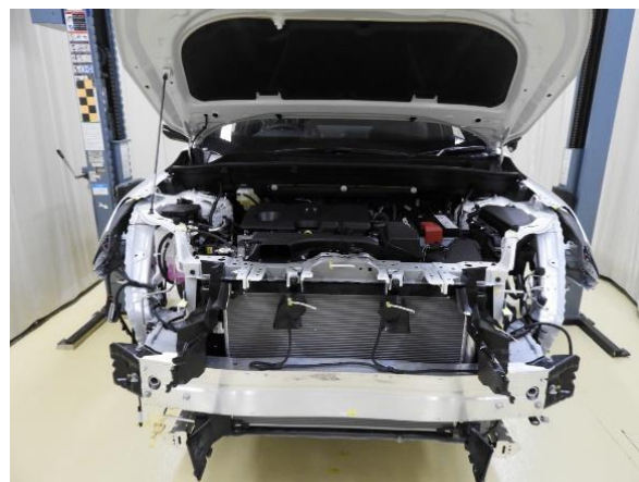
内板骨格損傷
