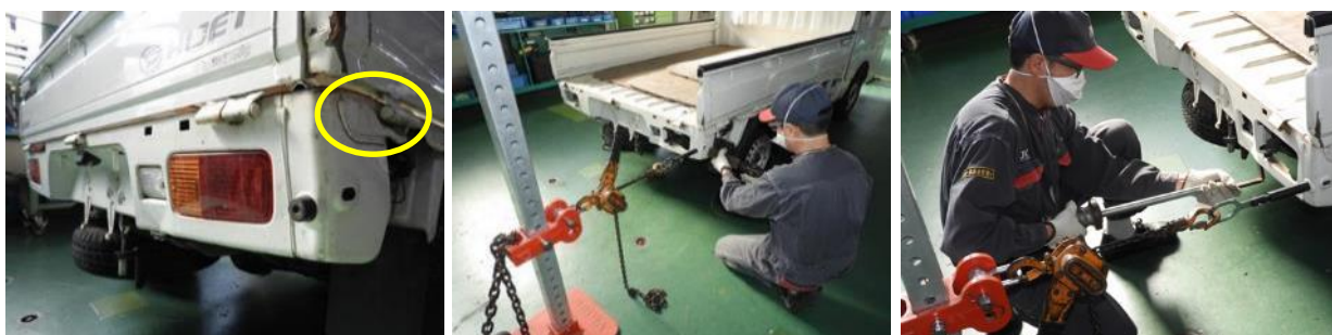
パネル C 右側面部の変形
