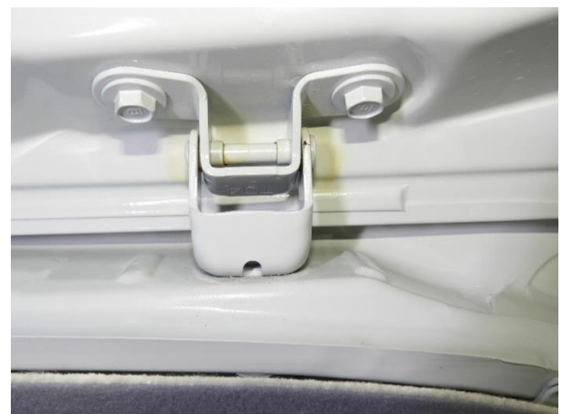
右テールゲート COMP ヒンジにはルーフパネル COMP との取り付け部の隙間は正常でした。
