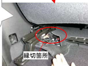
縁切箇所 ハーネス縁切 右側フロントシート下部でフロアカーペットをめくりハーネスを縁切る。
