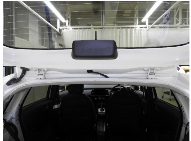
テールゲート COMP ヒンジ部を撮影しました。ヒンジ取付け相手部位へ顕著な変形は見られませんが、ルーフパネル COMP の波及損傷(歪み)を考えると分解後、リヤルーフレールの確認が必要です。
