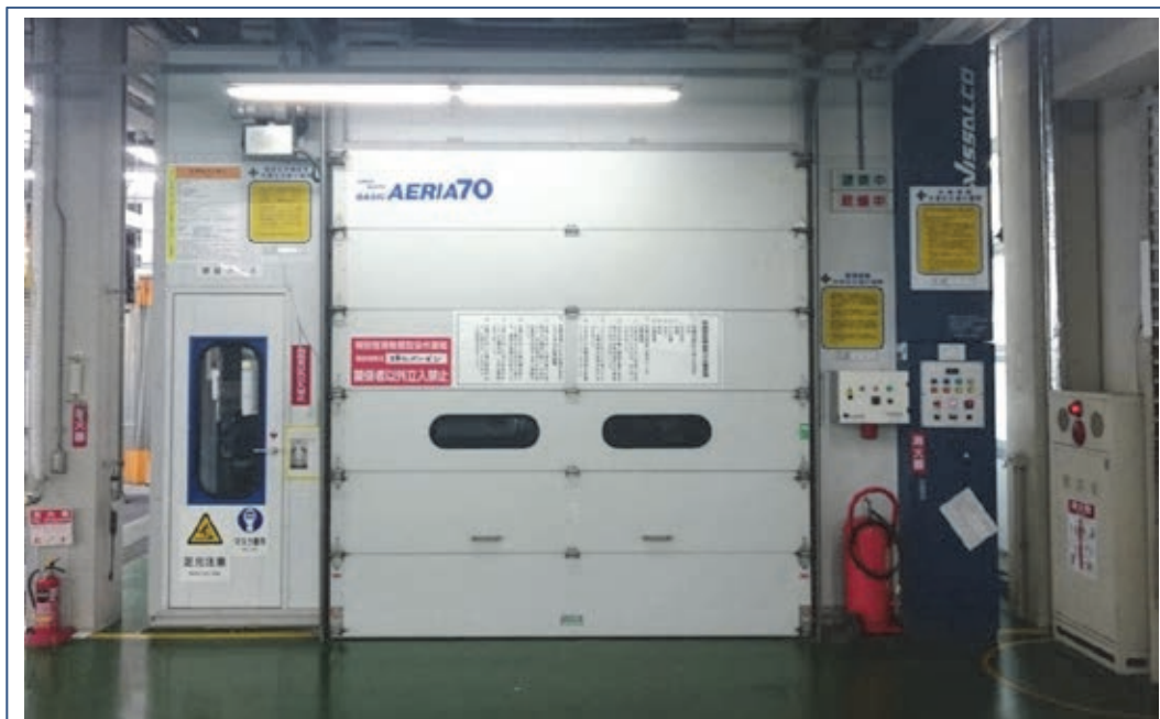
補修塗装に関する法令により、様々な表示がされた塗装ブース
