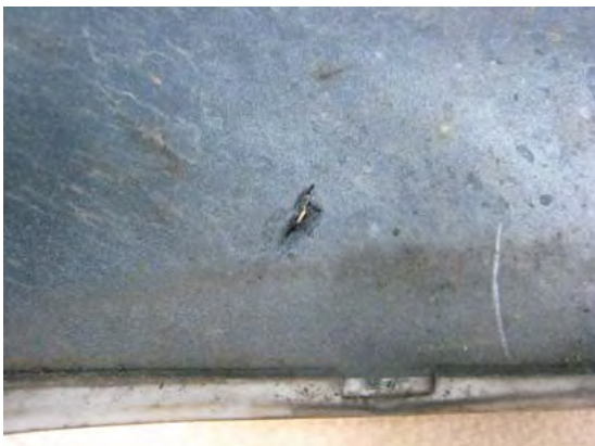
裏側損傷部(写真3)
